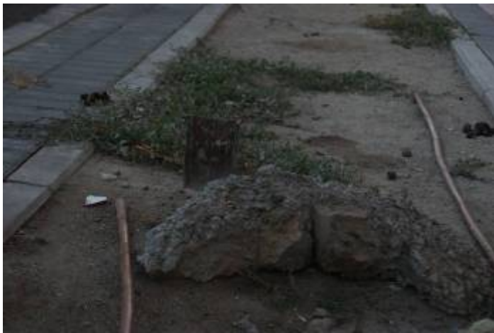
Av. de la Gavia, 70. En apenas un metro cuadrado, encontramos concentración de defecaciones caninas, trozo de hormigón y hierro sobresaliendo del suelo.
