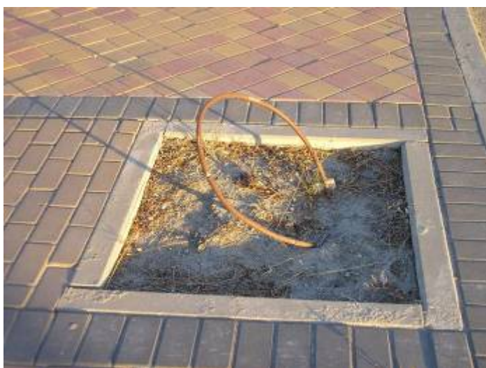
Av. del Mayorazgo. Una gran parte de los alcorques del barrio se encuentran en el estado que se ve en la imagen
